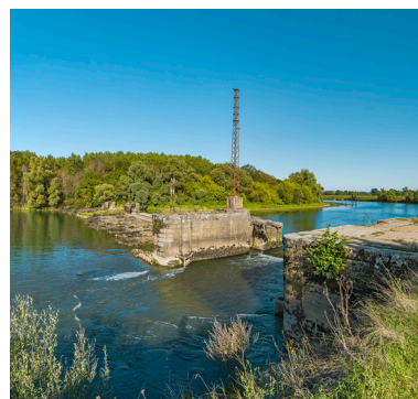
Vue d'ensemble du barrage en 2019 : au premier plan, l'ancien pertuis. Phot. Thierry Kuntz IVR26_20197100484NUC4A
