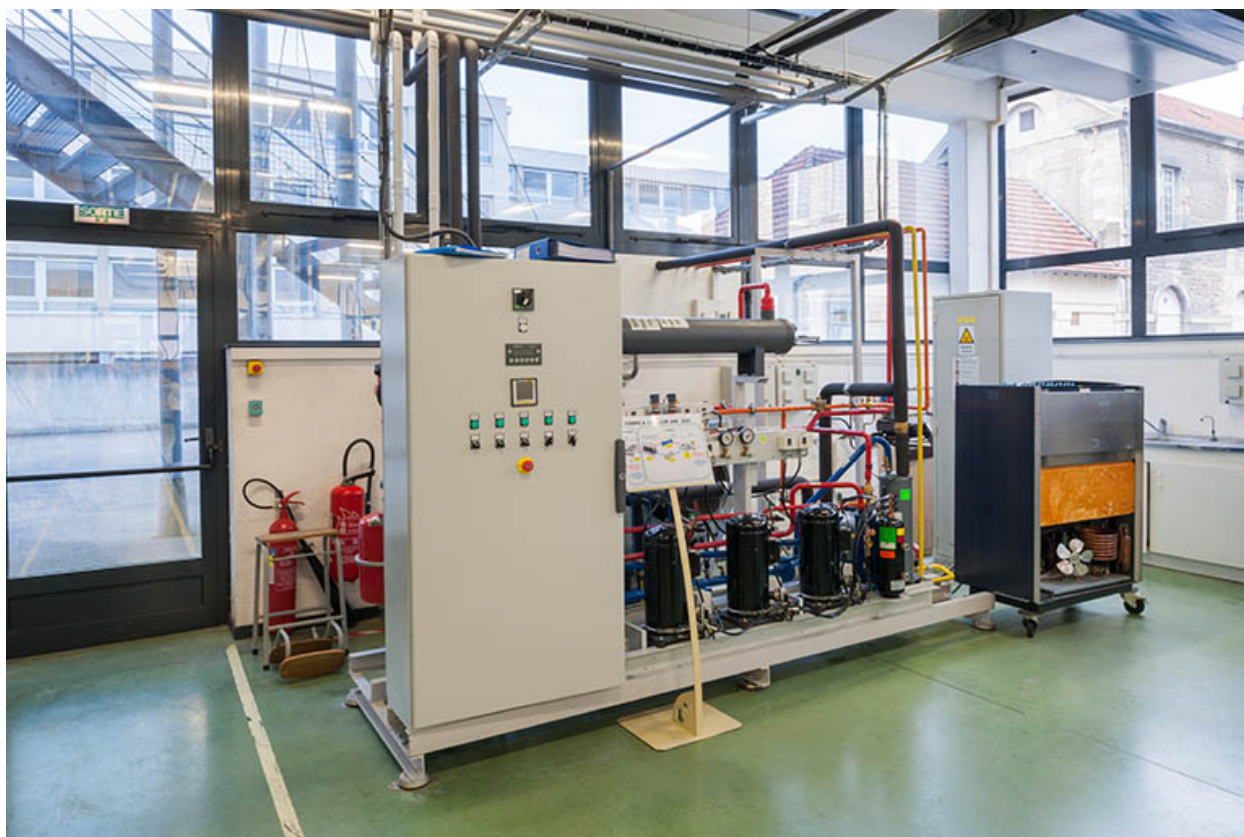
Atelier froid climatisation domotique.
