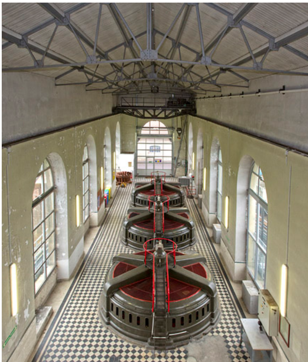
Salle des machines. Alignement des groupes turbo-alternateurs.
