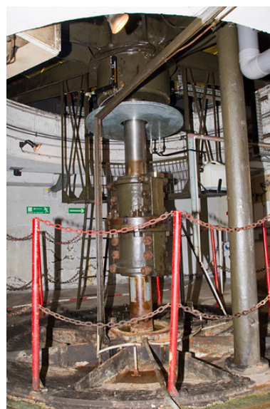
Détail de la transmission verticale d'une turbine. Phot. Yves Sancey IVR43_20122502064NUC2A
