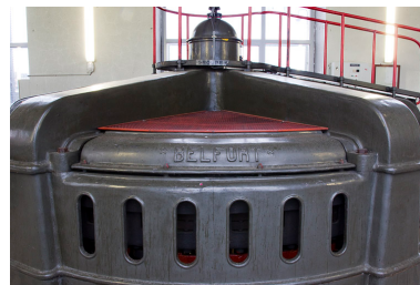
Détail d'un alternateur SACM. Phot. Yves Sancey IVR43_20122502062NUC2A
