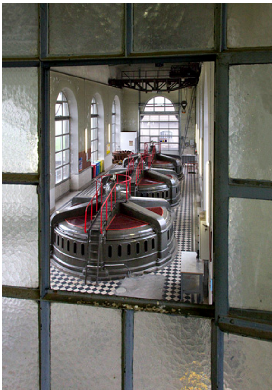
Vue plongeante sur la salle des machines.
