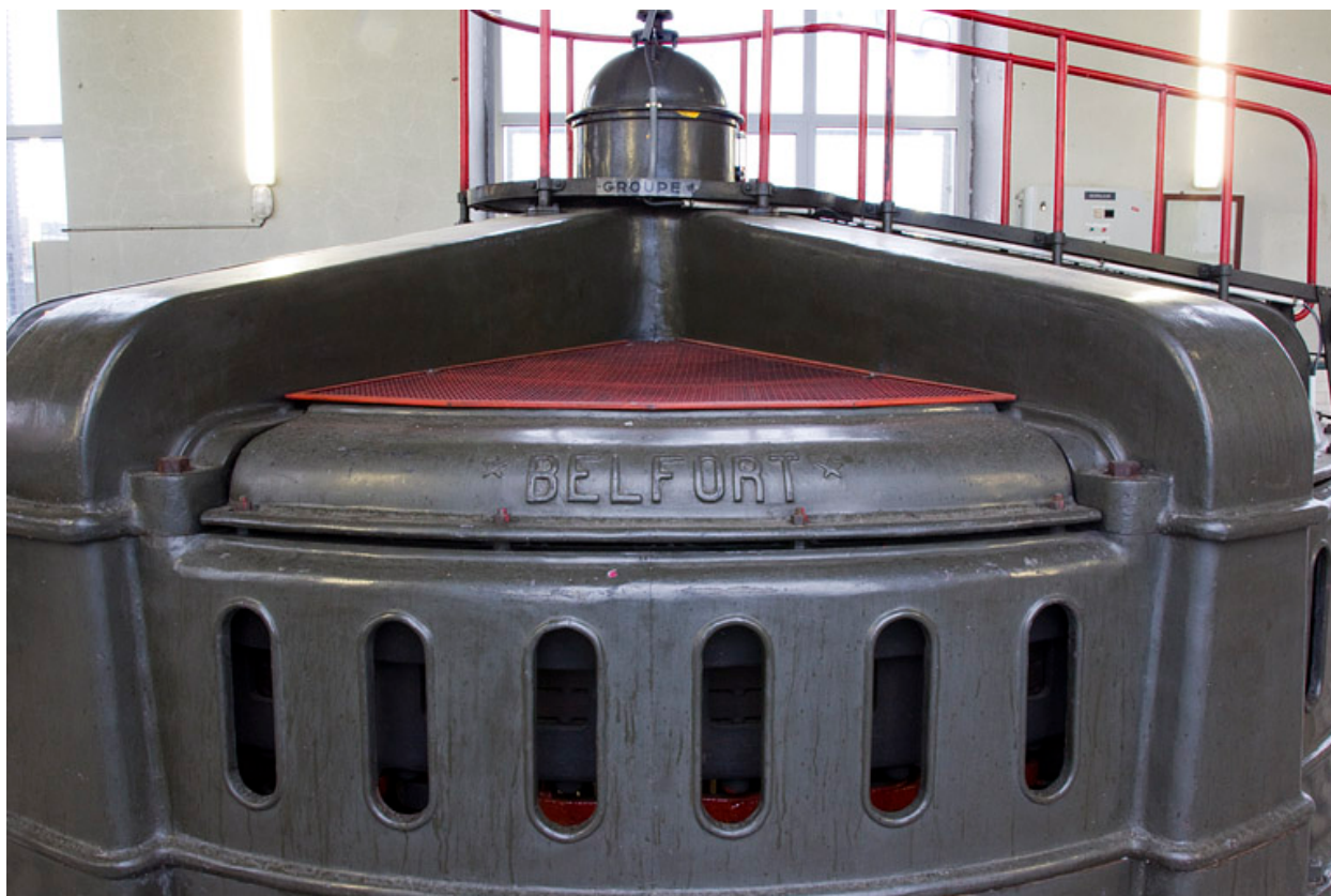
Détail d'un alternateur SACM.
