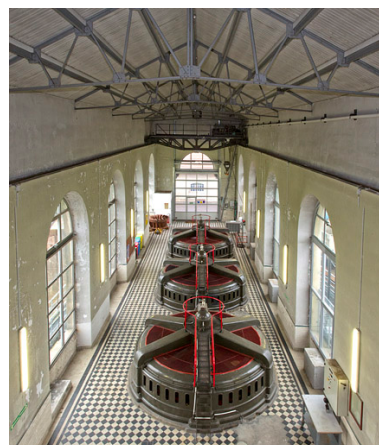
Salle des machines. Alignement des groupes turbo-alternateurs. Phot. Yves Sancey IVR43_20122502052NUC2A
