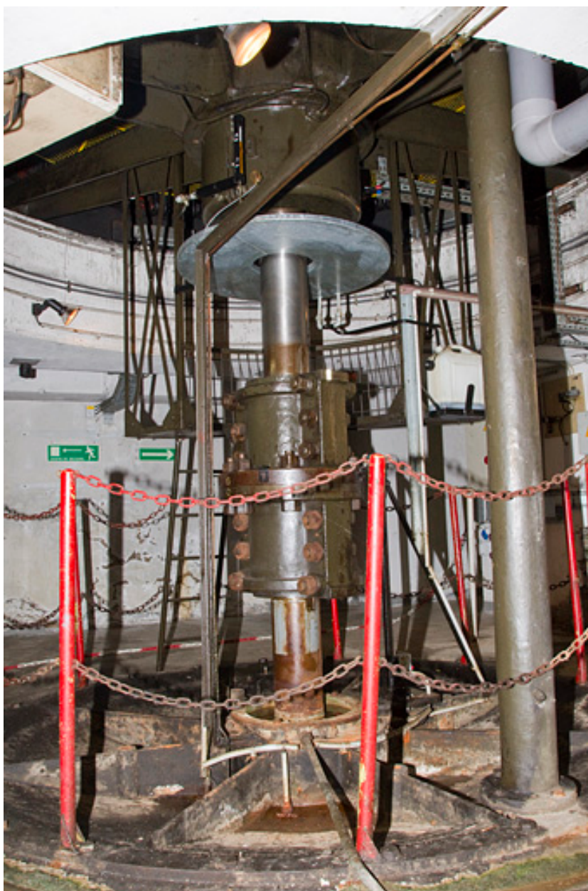
Détail de la transmission verticale d'une turbine.
