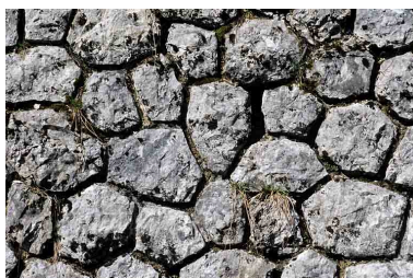
Tunnel du Chalet : détail de l'appareil du mur en aile, côté La Cluse. Phot. Yves Sancey IVR43_20053900590ZA
