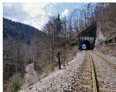
Tunnel de Tancua : vue d'ensemble, côté Andelot-en-Montagne (nord). Phot. Yves Sancey IVR43_20053900585XA
