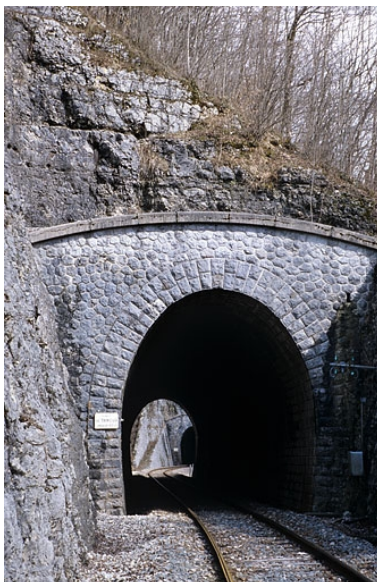
Tunnel de Tancua : tête côté La Cluse (sud). Phot. Yves Sancey IVR43_20053900596ZA
