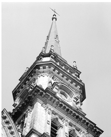
Derniers niveaux de la tour nord vus d'en dessous. Phot. Jérôme Mongreville IVR43_19882500109X
