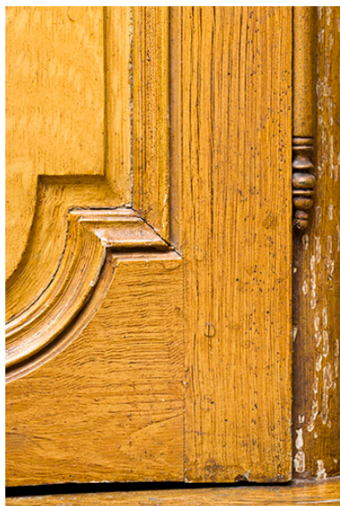
Intérieur : détail des lambris de revêtement du salon, toile peinte à l'imitation du bois. Phot. Sonia Dourlot IVR43_20157000371NUC2A
