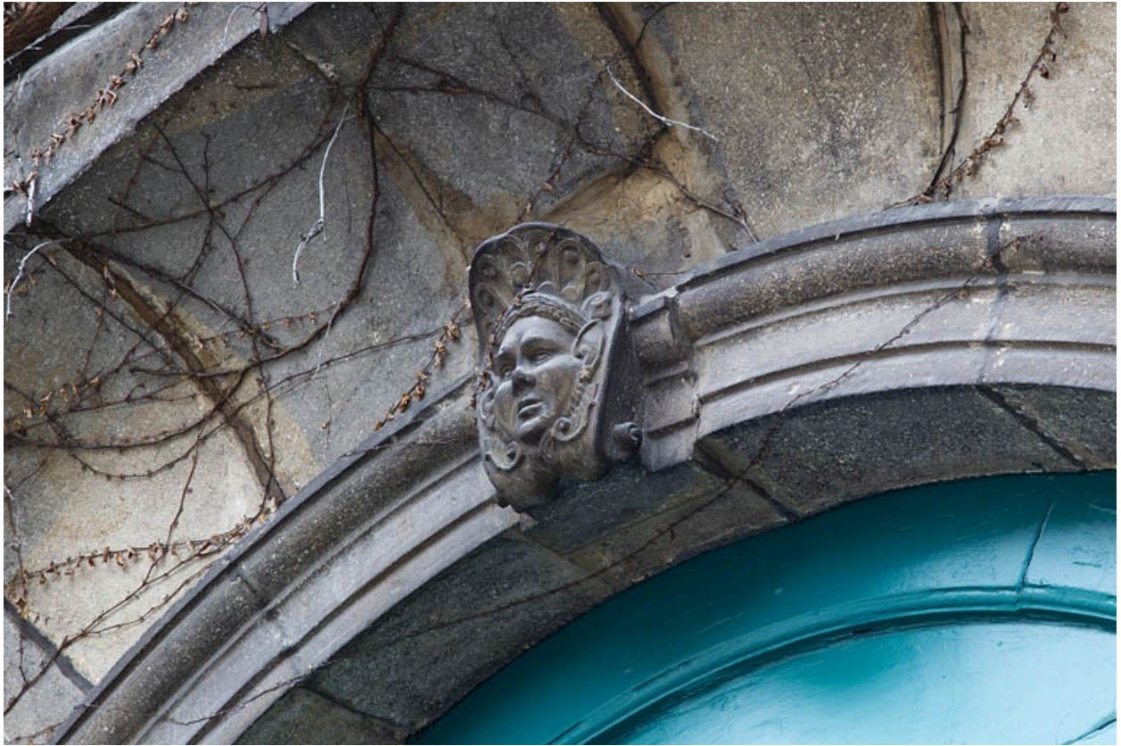
Logis secondaire, façade sur rue : détail du décor de la clé de l'arc du portail d'entrée, de trois quarts droit.
