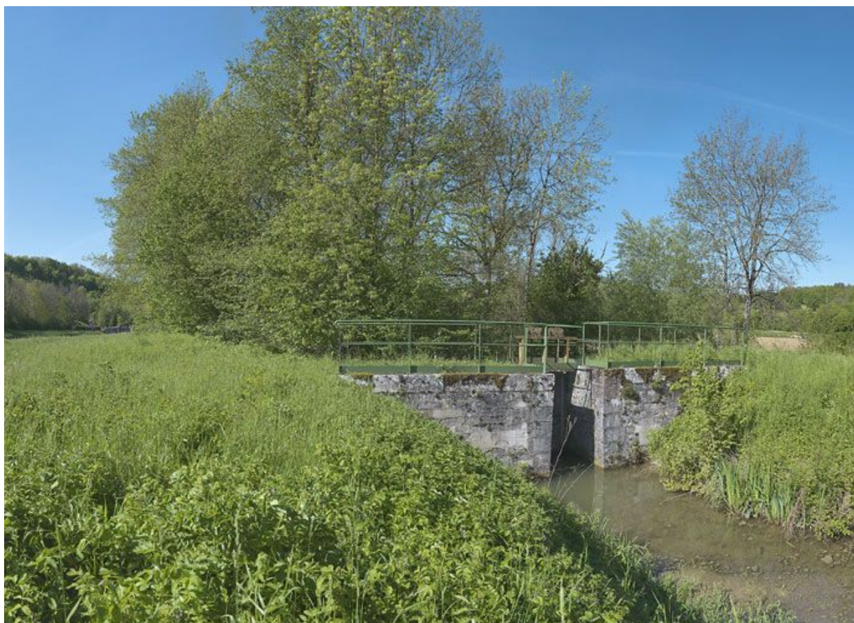
Vanne de prise d'eau.
