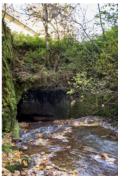
Couverture sur le ruisseau de la Douve, en amont du bâtiment. Phot. Sonia Dourlot IVR43_20172501713NUC4A
