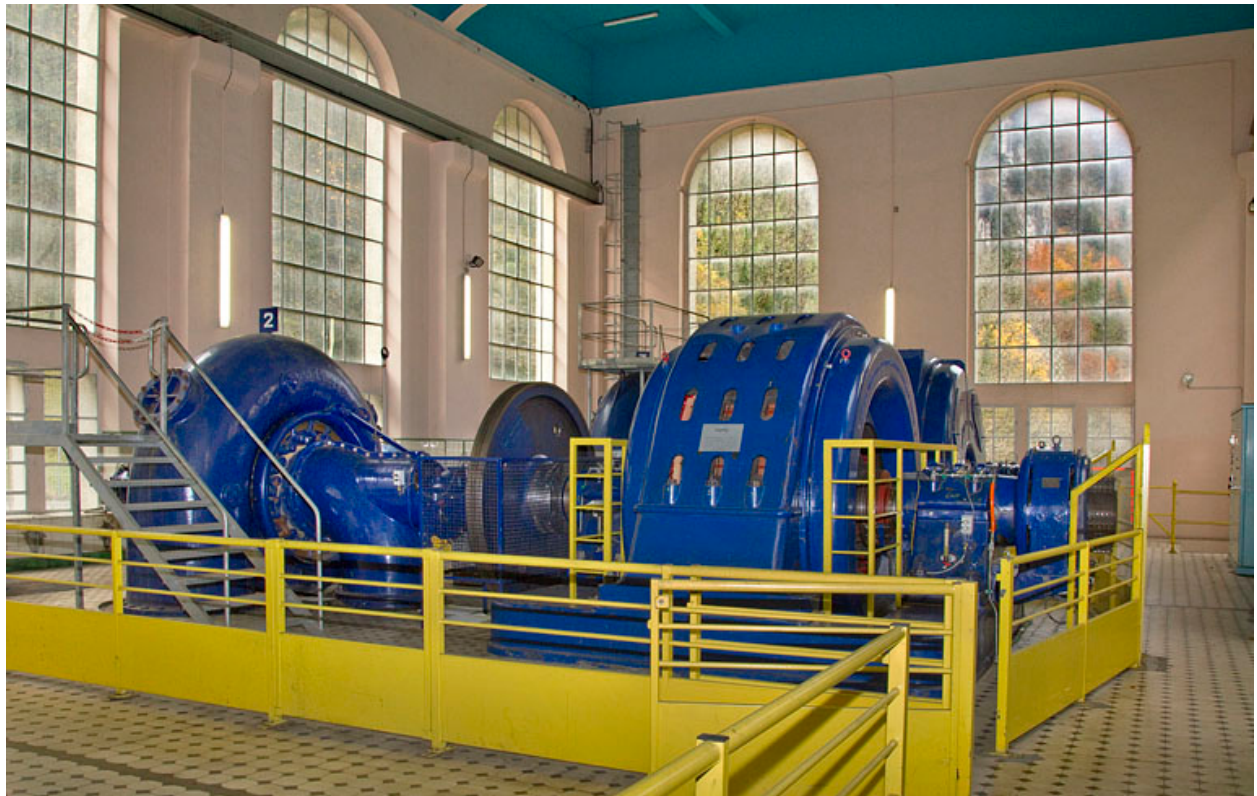
Centrale hydroélectrique du Refrain (Charquemont). Groupes turbo-alternateur.
