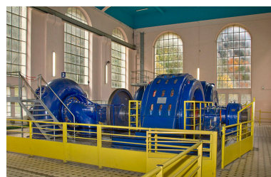
Centrale hydroélectrique du Refrain (Charquemont). Groupes turbo-alternateur. Phot. Yves Sancey IVR43_20122502121NUC2A
