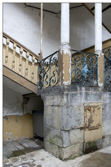
Détail du soubassement de l'escalier à cage ouverte et de l'entrée de cave.
