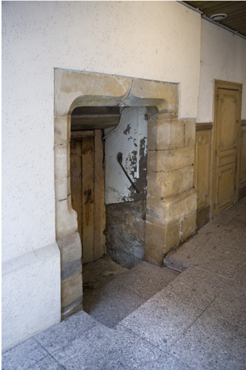
Premier logis secondaire : détail de la porte d'entrée de l'escalier en vis.
