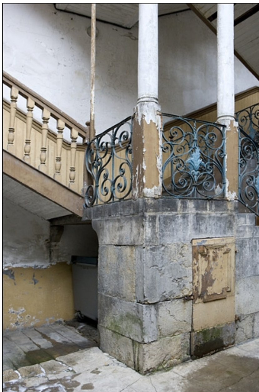
Détail du soubassement de l'escalier à cage ouverte et de l'entrée de cave.
