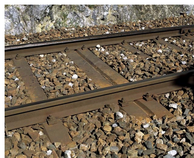
Traverses simples et doubles. Ces traverses sont en place près du point kilométrique 100.200, peu avant le souterrain d'Arbent 1 (commune d'Arbent, Ain). Phot. Yves Sancey IVR43_20050100048XA
