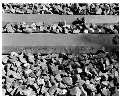
Inscription sur une traverse double : H. Wendel. Cette traverse est en place près du point kilométrique 100.200, peu avant le souterrain d'Arbent 1 (commune d'Arbent, Ain). Phot. Yves Sancey IVR43_20050100051X
