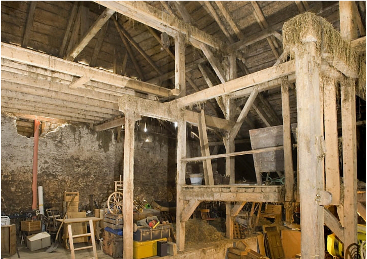
Déchargeuse : charpente et plateforme dans la grange.
