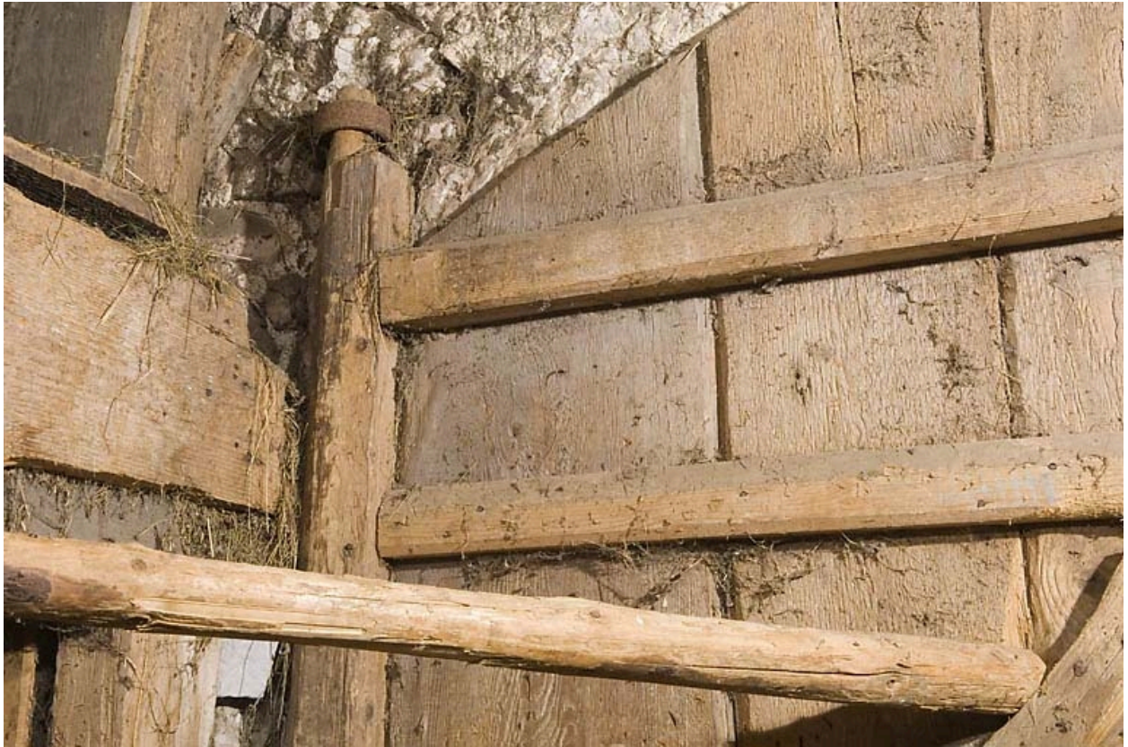
Façade antérieure, porte de grange : fixation de l'axe vertical du vantail de droite (collier en partie haute).
