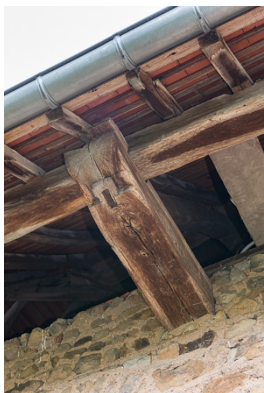
Cette solive, sur laquelle repose le plancher des combles de la maison, forme encorbellement et soutien le débord du toit. Le trou (ou mortaise) indique qu'un pilier en bois venait s'assembler avec la solive. Ce pilier était un élément de la galerie qui se développait à l'origine au premier étage de la façade de la maison. Phot. Pierre-Marie Barbe-Richaud IVR26_20197100290NUC4A
