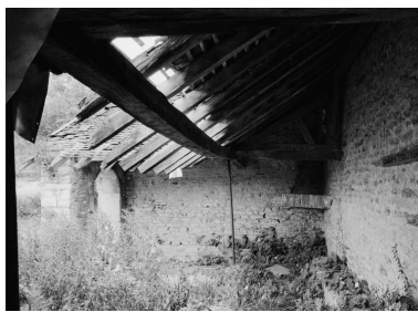
Vue de l'intérieur du lavoir. Phot. Jean-Luc Duthu IVR26_19792101177V
