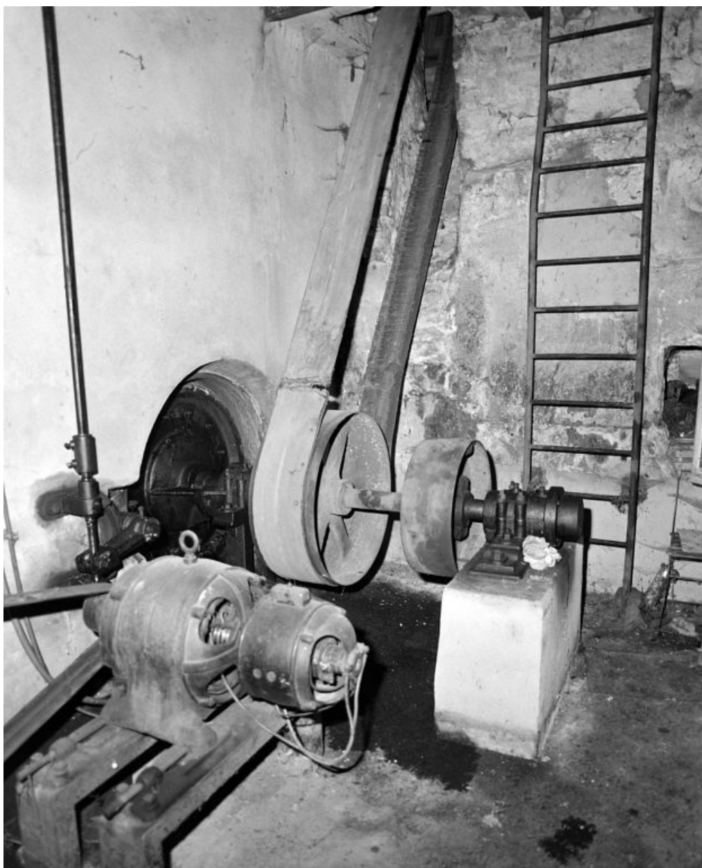
Etage de soubassement. Turbine et générateurs.
