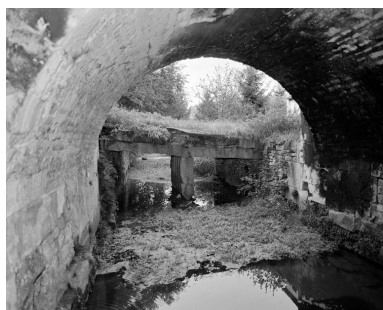
La chambre d'eau. Vue prise depuis la salle des turbines. Phot. Jean-Luc Duthu IVR26_20062106634X
