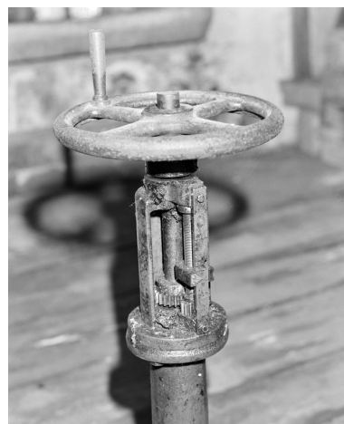
Rez-de-chaussée. Commande d'ouverture de vanne, détail. Phot. Jean-Luc Duthu IVR26_20062106675X
