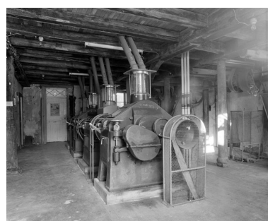
Rez-de-chaussée. Broyeurs. Phot. Jean-Luc Duthu IVR26_20062106644X
