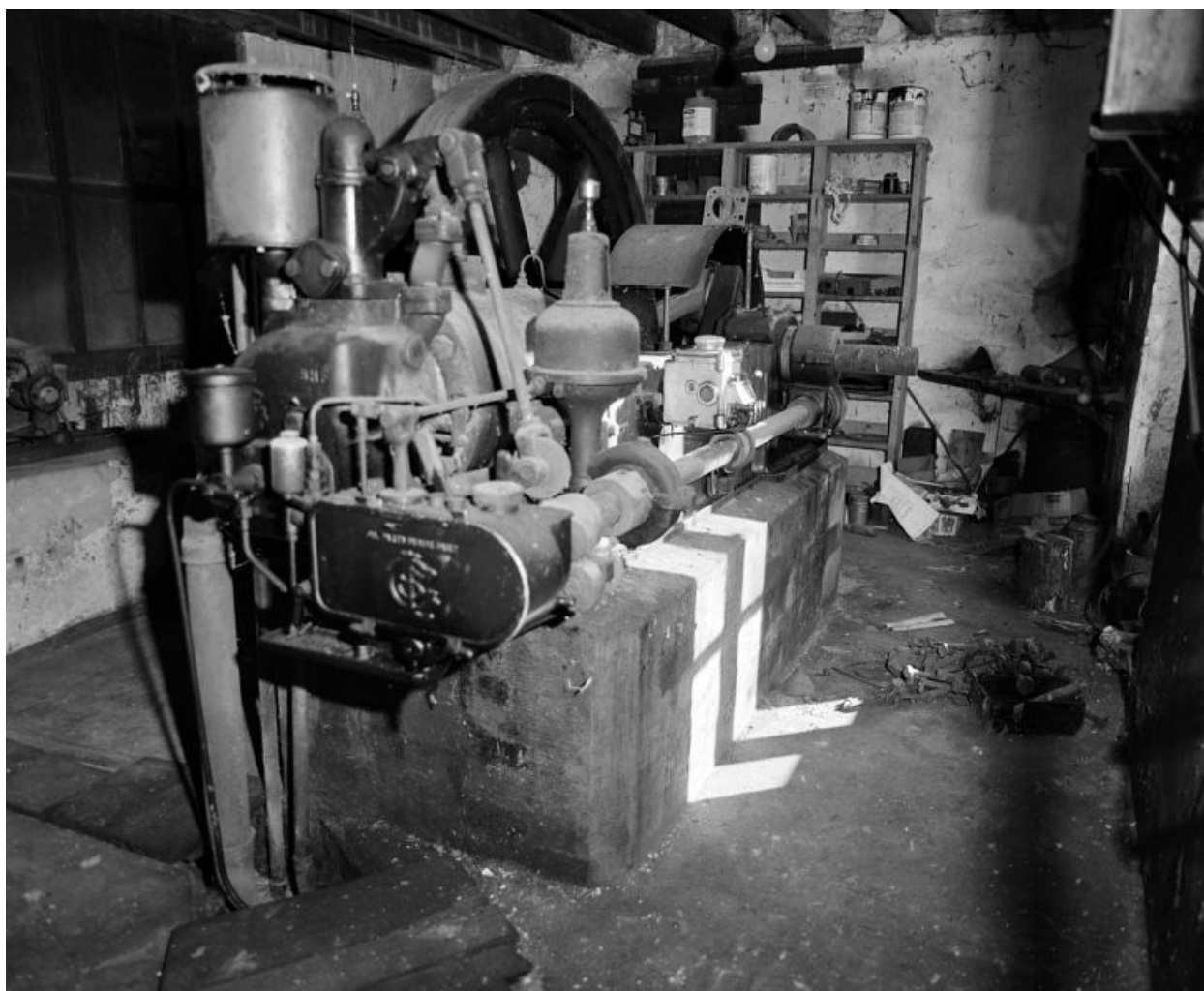
Rez-de-chaussée. Moteur diesel (L. Gardner, constructeur à Patricroft, Angleterre).
