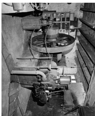
Rez-de-chaussée. Moteur diesel (L. Gardner, constructeur à Patricroft, Angleterre). Phot. Jean-Luc Duthu IVR26_20062106676X
