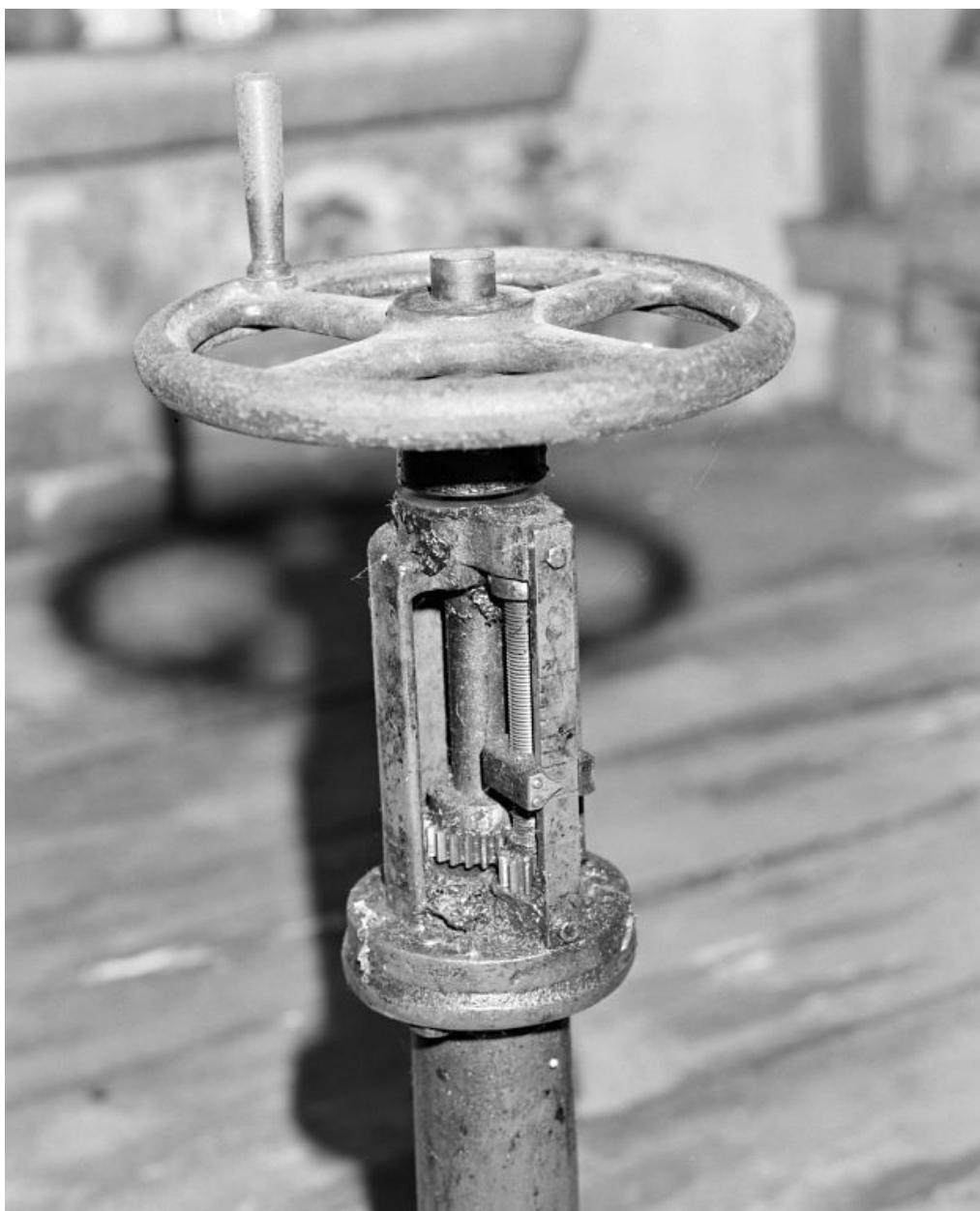
Rez-de-chaussée. Commande d'ouverture de vanne, détail.
