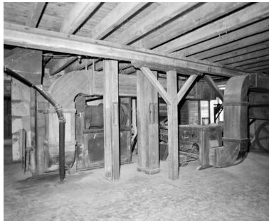
2e étage. Trieurs à blé, vue d'ensemble. Phot. Jean-Luc Duthu IVR26_20062106725X
