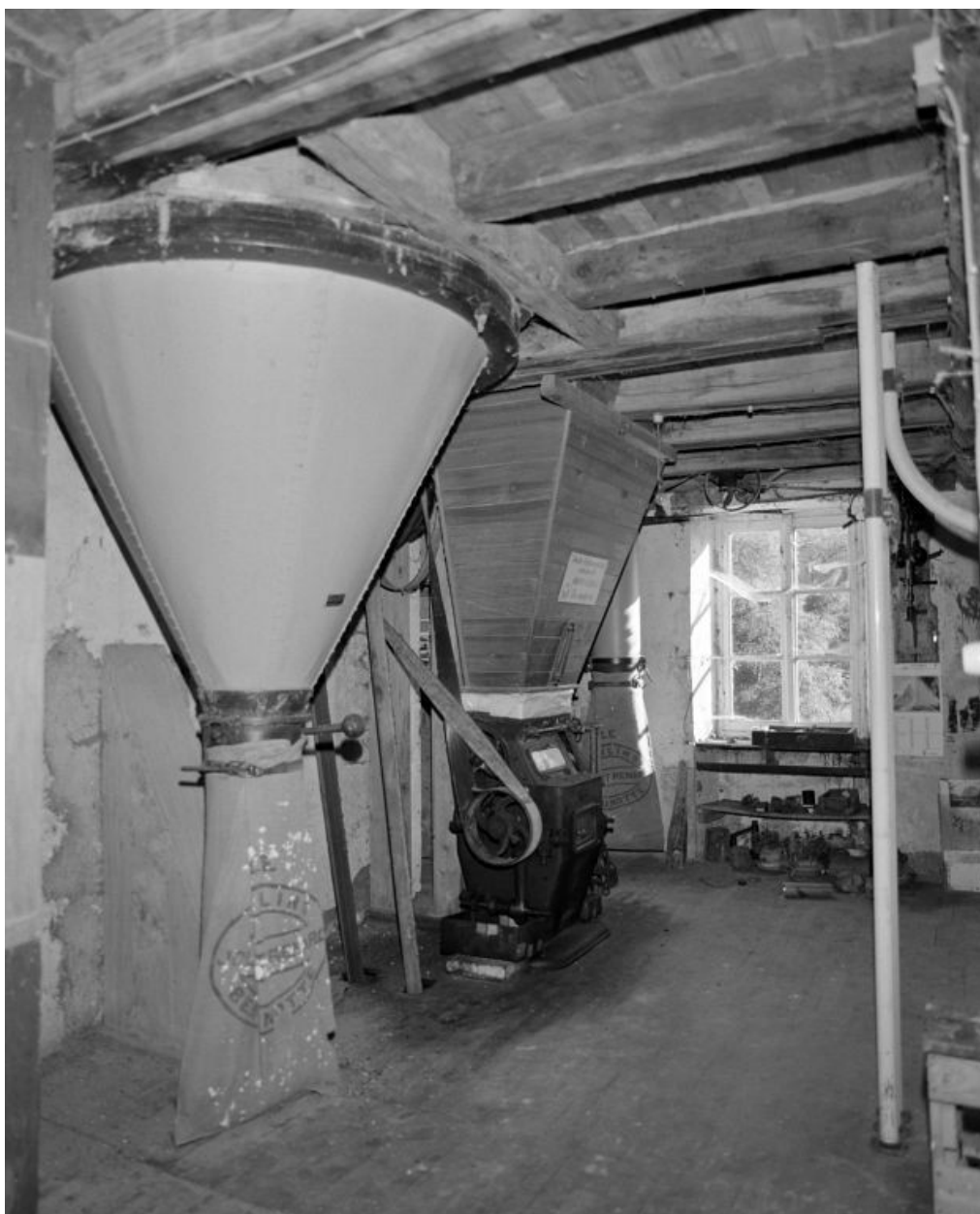
1er étage. Broyeur et ensacheur.
