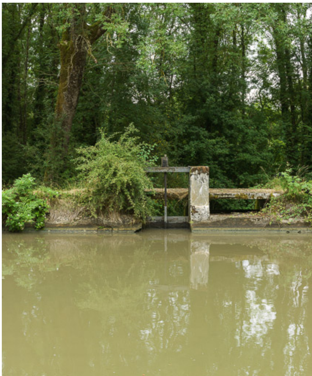
Vue de l'ensemble hydraulique.
