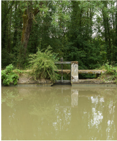
Vue de l'ensemble hydraulique. Phot. Pierre-Marie Barbe-Richaud IVR26_20175800380NUC2A
