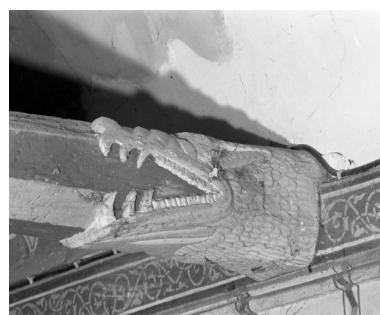
Charpente de la nef, engoulant gauche du 2ème entrait Phot. Jean-Luc Duthu IVR26_19852100999X
