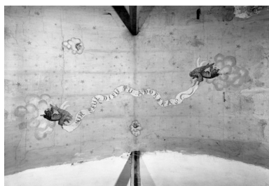
Nef, décor peint sur papier de la fausse voûte à l'aplomb de la tribune
