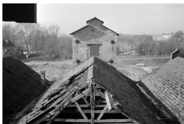
Toiture de la halle centrale de l'atelier de fabrication et monte-charge (D). Phot. Laurent Poupard IVR43_19883900261Z
