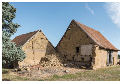
Vue des deux ailes de dépendances. A la jonction des deux bâtiments, une ancienne étable à bovins a été démolie suite à l'effondrement de sa charpente.. Phot. Pierre-Marie Barbe-Richaud IVR26_20197100330NUC4A
