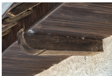
Vue de détail de la date 1722 sur un élément de charpente. Phot. Pierre-Marie Barbe-Richaud IVR26_20187100372NUC4A
