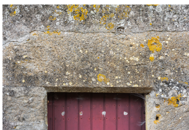
Vue rapprochée du linteau qui porte la date : 1685 (?) Phot. Pierre-Marie Barbe-Richaud IVR26_20187100379NUC4A
