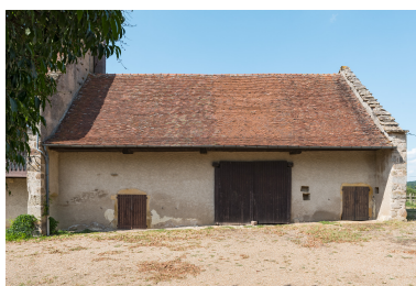
Vue de face de la façade antérieure de la partie agricole : grange et étables. Phot. Pierre-Marie Barbe-Richaud IVR26_20187100370NUC4A
