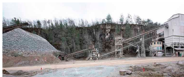
Nouvelles installations : tapis roulants et poste de concassage.
