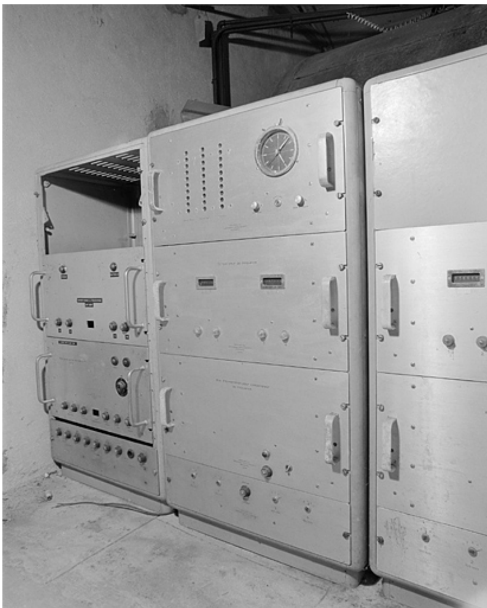
3e, 4e et 5e armoires, conservées à l'Observatoire. De gauche à droite, la station de secours (5e armoire) et les deux armoires des comparateurs de fréquence (3e et 4e armoires).
