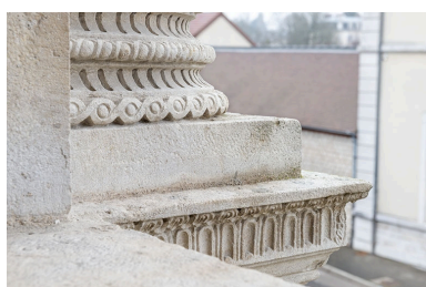
Loggia : décor de la base d'une colonne. Phot. Jérôme Mongreville IVR43_20223900198NUC4A
