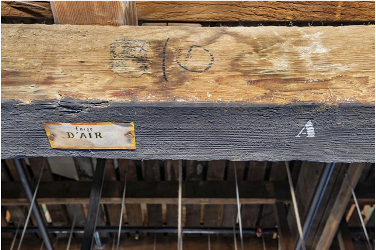
Cage de scène : identification d'une frise, passerelle côté cour.
