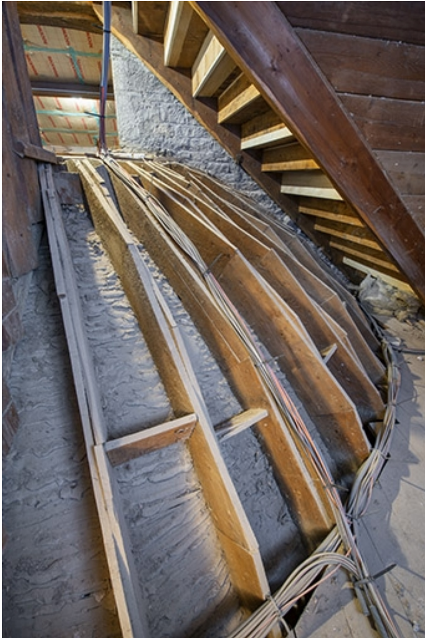
Foyer : extrados de la fausse-voûte en cul-de-four de l'antichambre (côté jardin), dans le comble.
