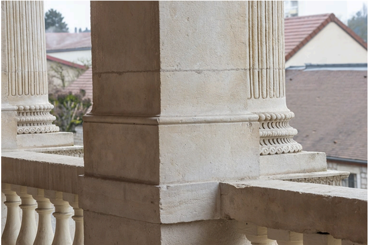
Loggia : base d'un pilier et de colonnes. Les balustres du garde-corps sont en fonte.
