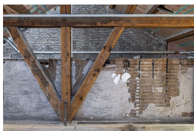
Salle : paroi en bois isolant le 4e balcon (poulailler) du comble. Phot. Jérôme Mongreville IVR43_20223900267NUC4A
