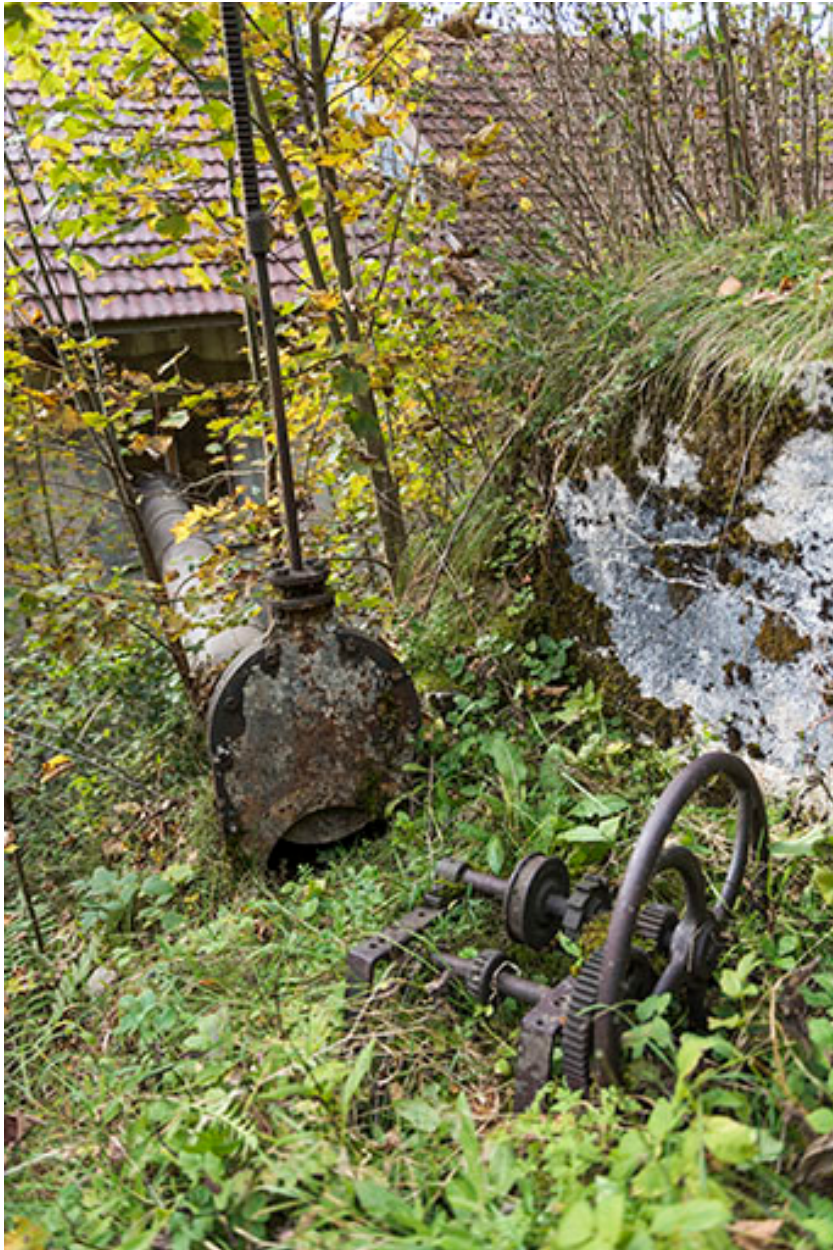
Eléments de vannage pour la prise d'eau de la turbine.
