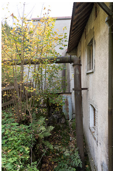
Atelier de fabrication : tuyau d'amenée d'eau de la turbine (façade postérieure).
