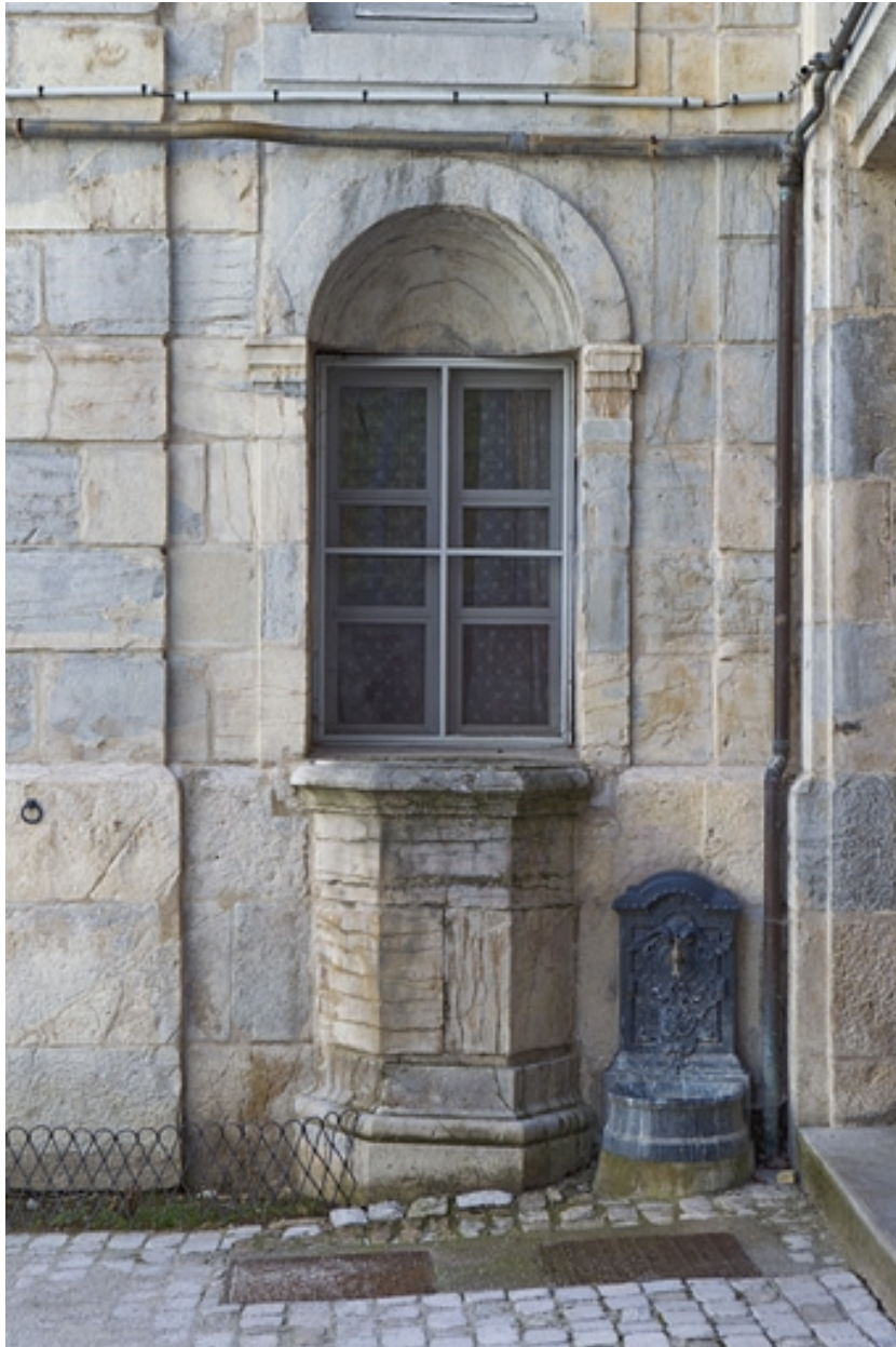
Vue d'ensemble du puits et de la borne fontaine appuyés contre le mur de clôture de la cour.
