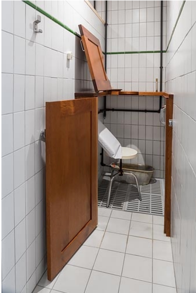
Étuves locales, au rez-de-chaussée (pavillon annexe de 1897).
