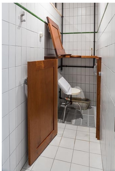
Étuves locales, au rez-de-chaussée (pavillon annexe de 1897). Phot. Pierre-Marie Barbe-Richaud IVR26_20217100182NUC4A
