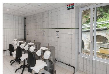
Étuves locales, au rez-de-chaussée (pavillon annexe de 1897). Phot. Pierre-Marie Barbe-Richaud IVR26_20217100181NUC4A
