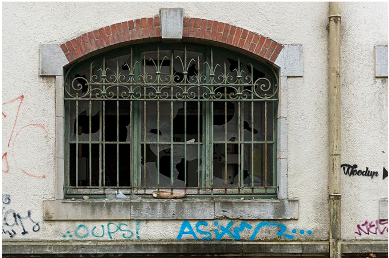
Etat en 2016. Usine A : baie large au rez-de-chaussée des bureaux, côté rue.
