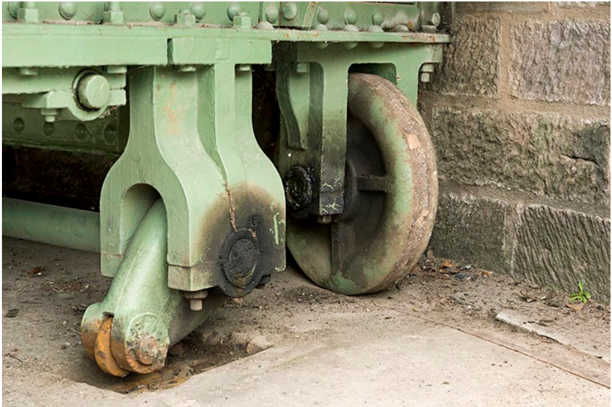
Système de calage levé (côté amont).
