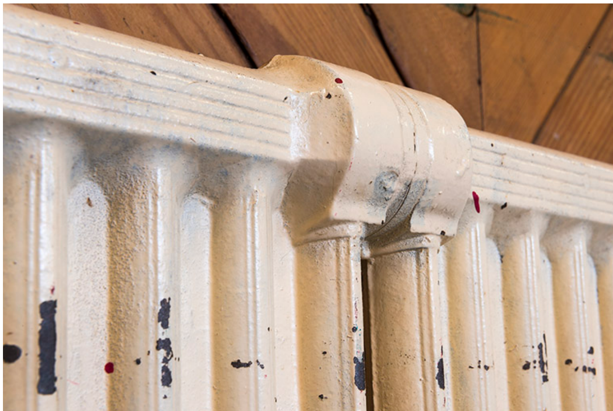
Détail d'un des radiateurs en fonte.
