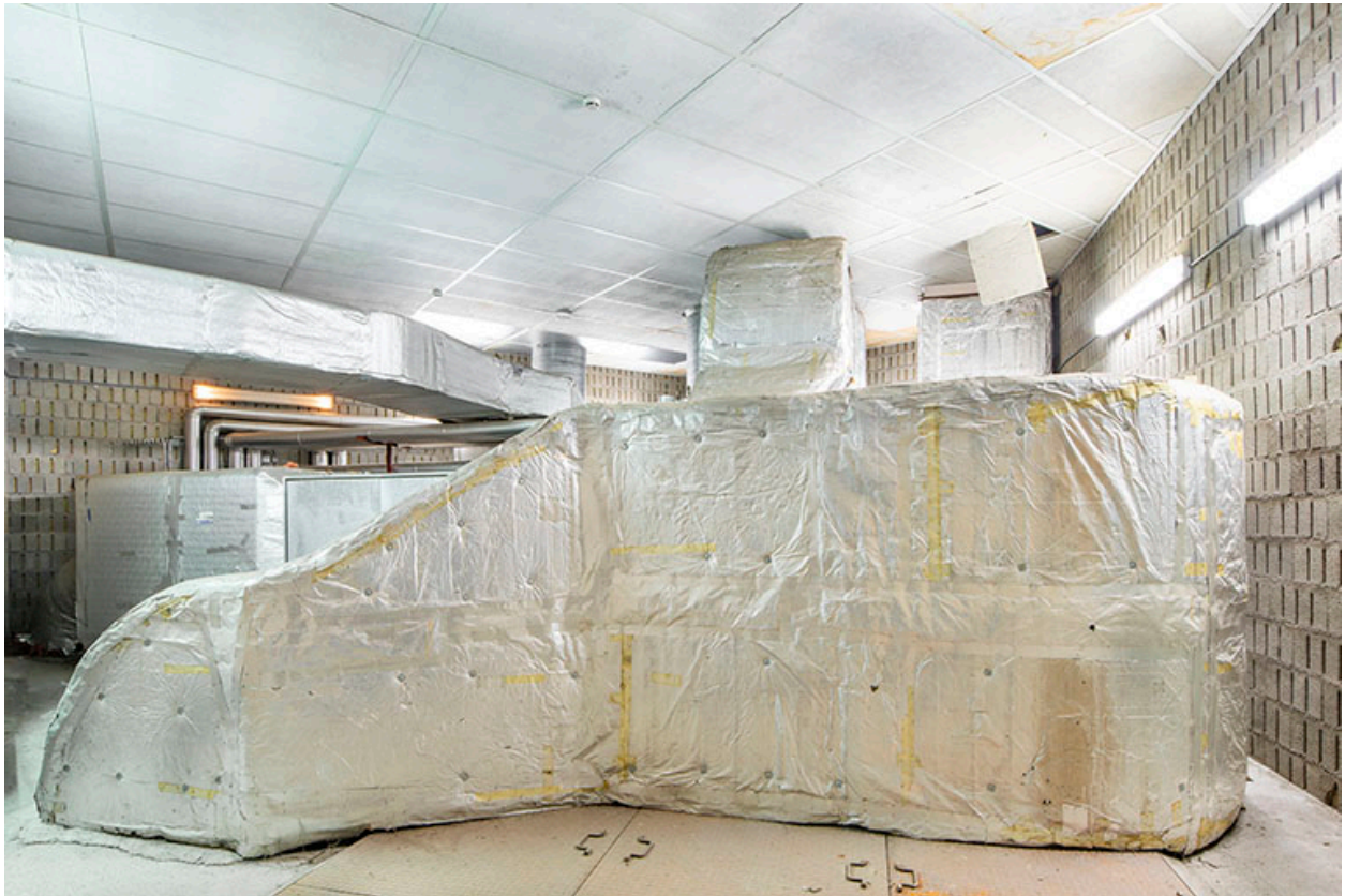
Grand Kursaal : local de la ventilation.
