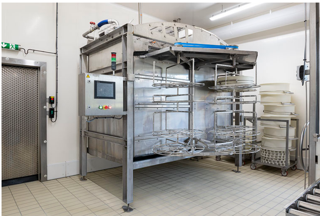
Installation de lavage.
