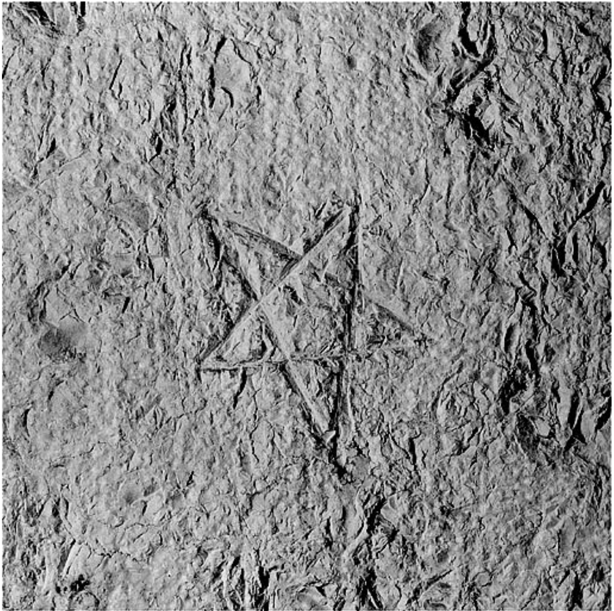
Traces de boucharde et signe lapidaire sur le premier contrefort nord de l'abside.
