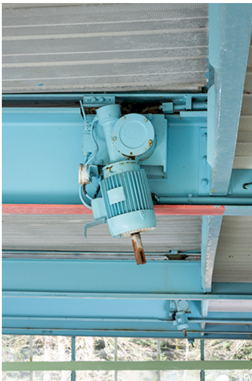
L'un des moteurs ouvrant le toit.
