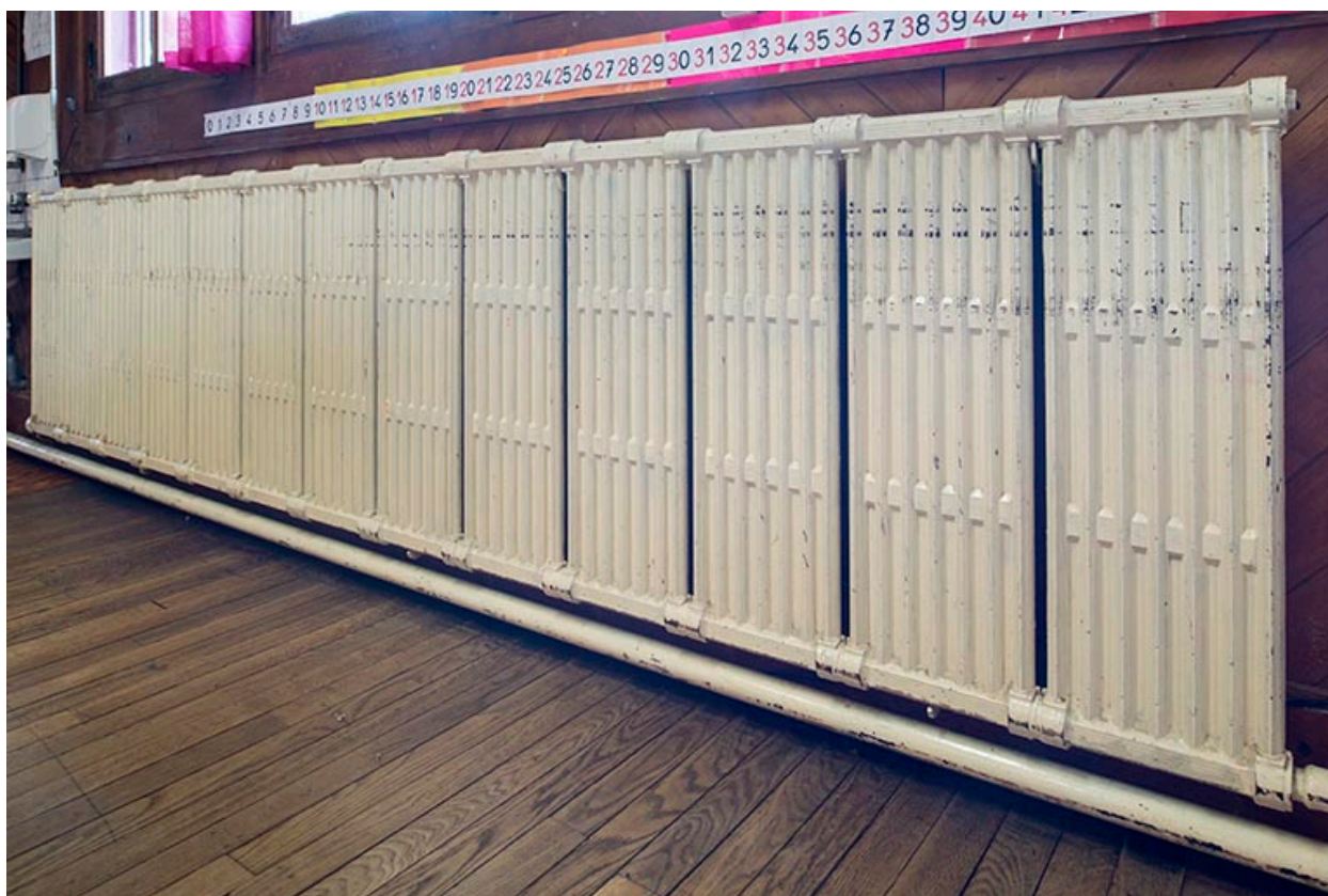
Les radiateurs d'une salle de classe.
