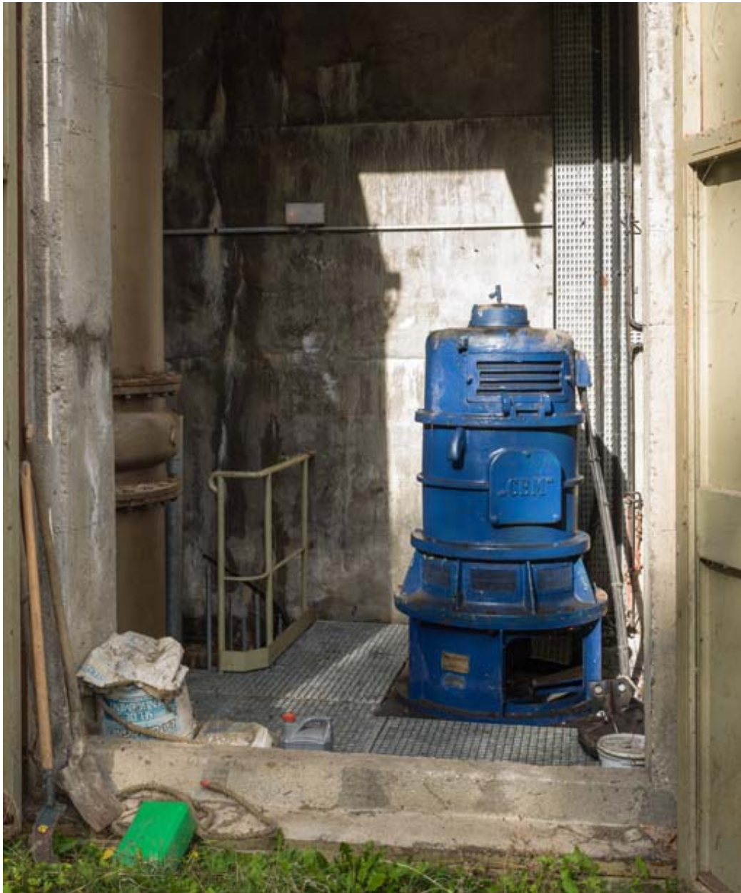
Détail de la station de pompage.
