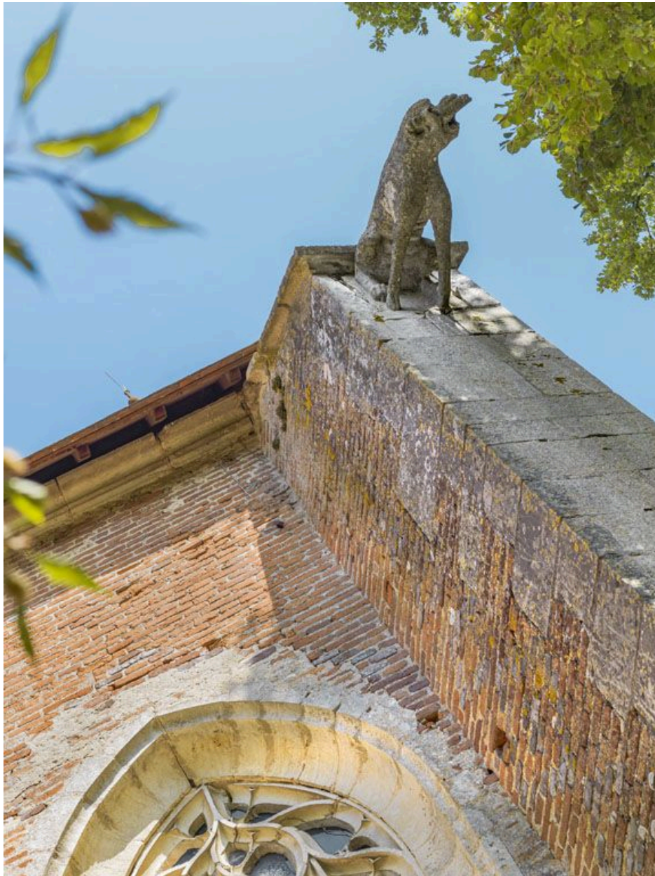
Gargouille sur le contrefort droit du chevet.
