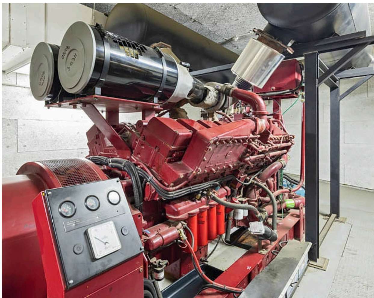
Groupe électrogène de secours (détail).
