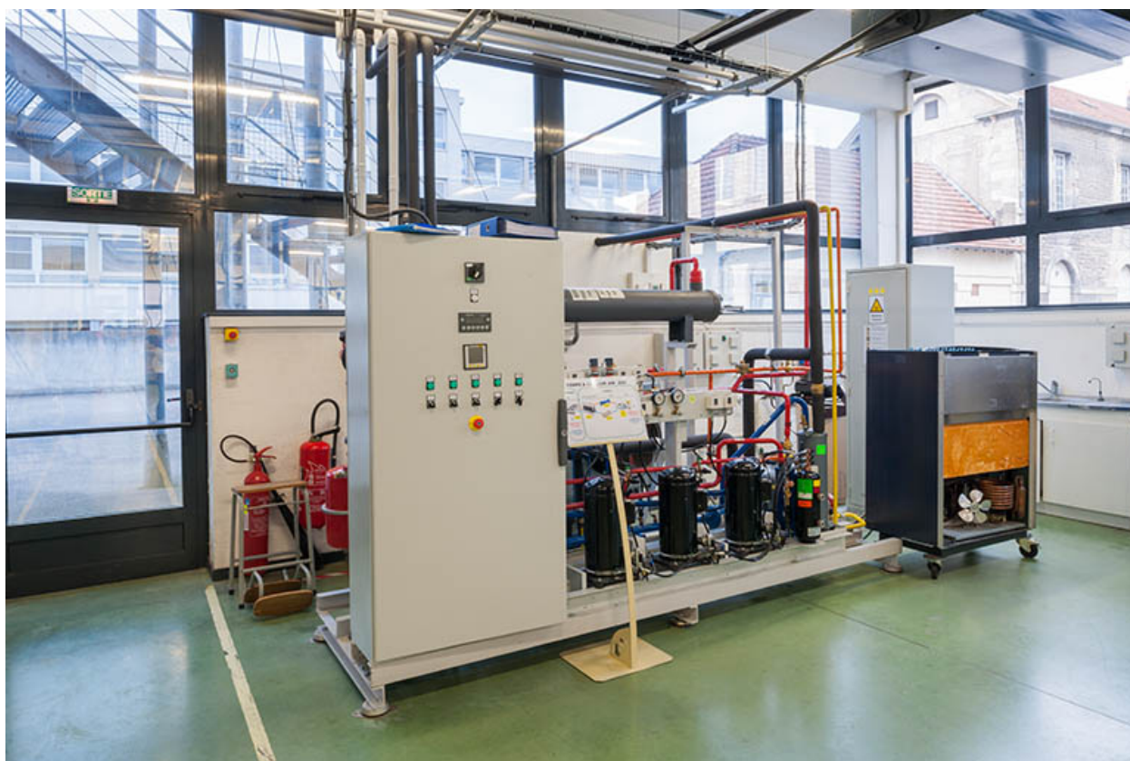
Atelier froid climatisation domotique.
