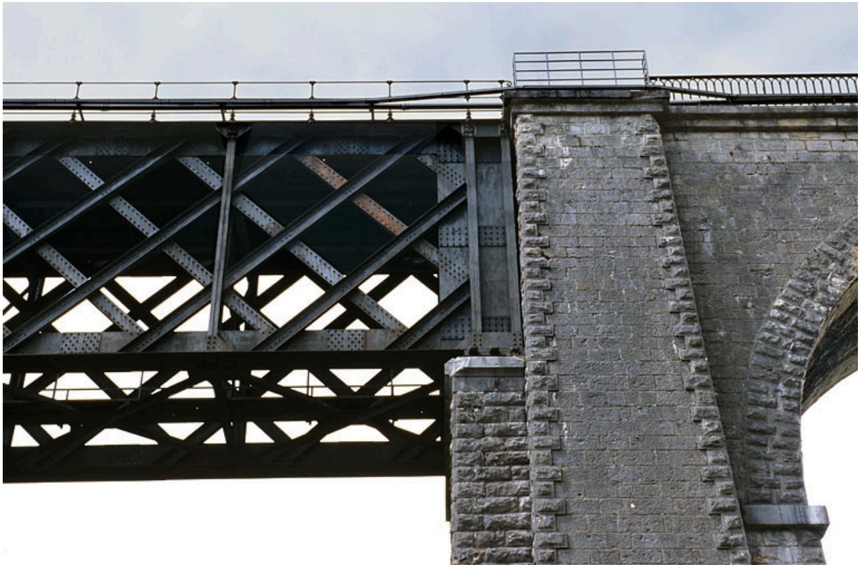
Détail de la jonction de la travée métallique et de l'arche en maçonnerie, rive droite.
