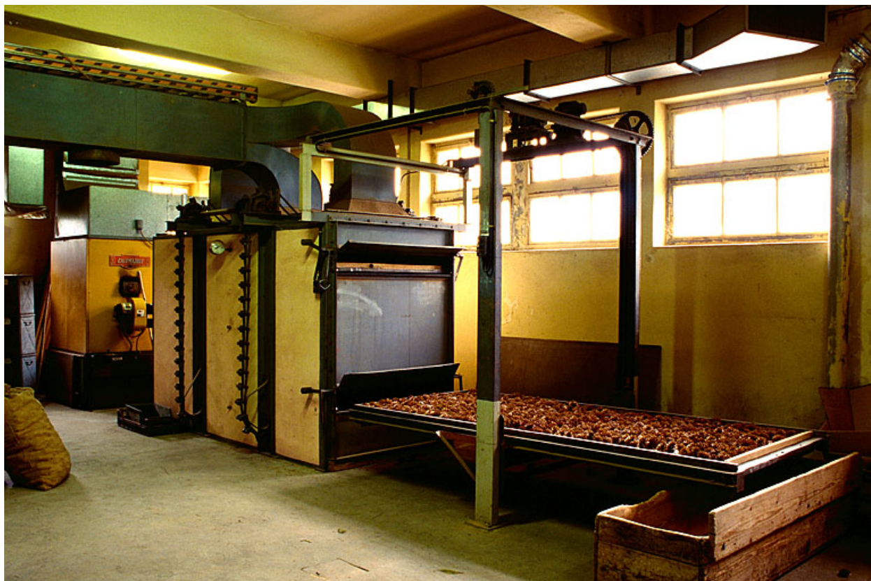
Vue d'ensemble. De gauche à droite : chaudière, séchoir et grille chargée de cônes sur le portique.
