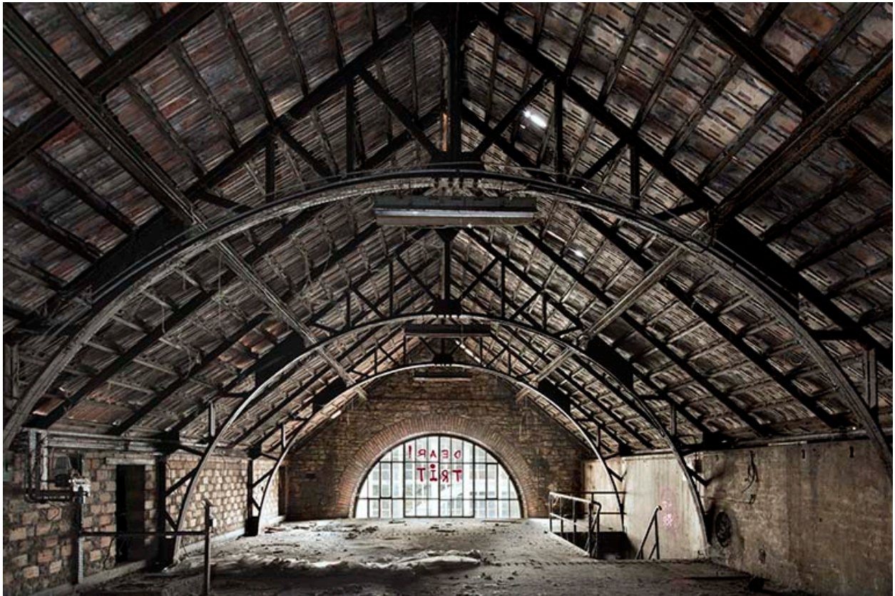
Etat en 2016. Usine A : étage en surcroît (avec charpente métallique) de la chaufferie.
