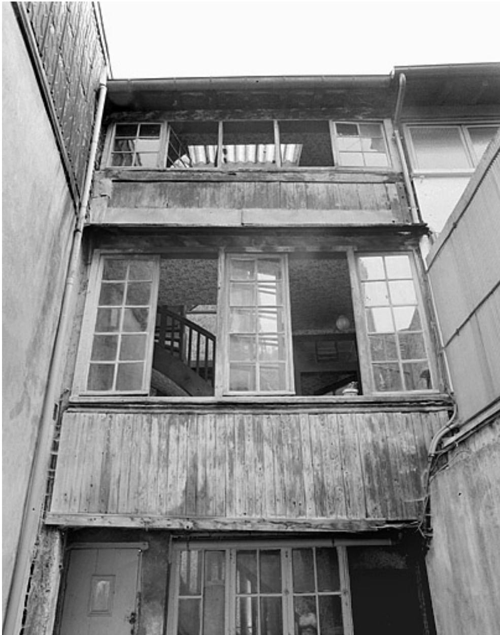
Maison 16 droite, rue du Faubourg. Façade sur cour du premier corps de bâtiment. Fin 18e ou début 19e siècle.
