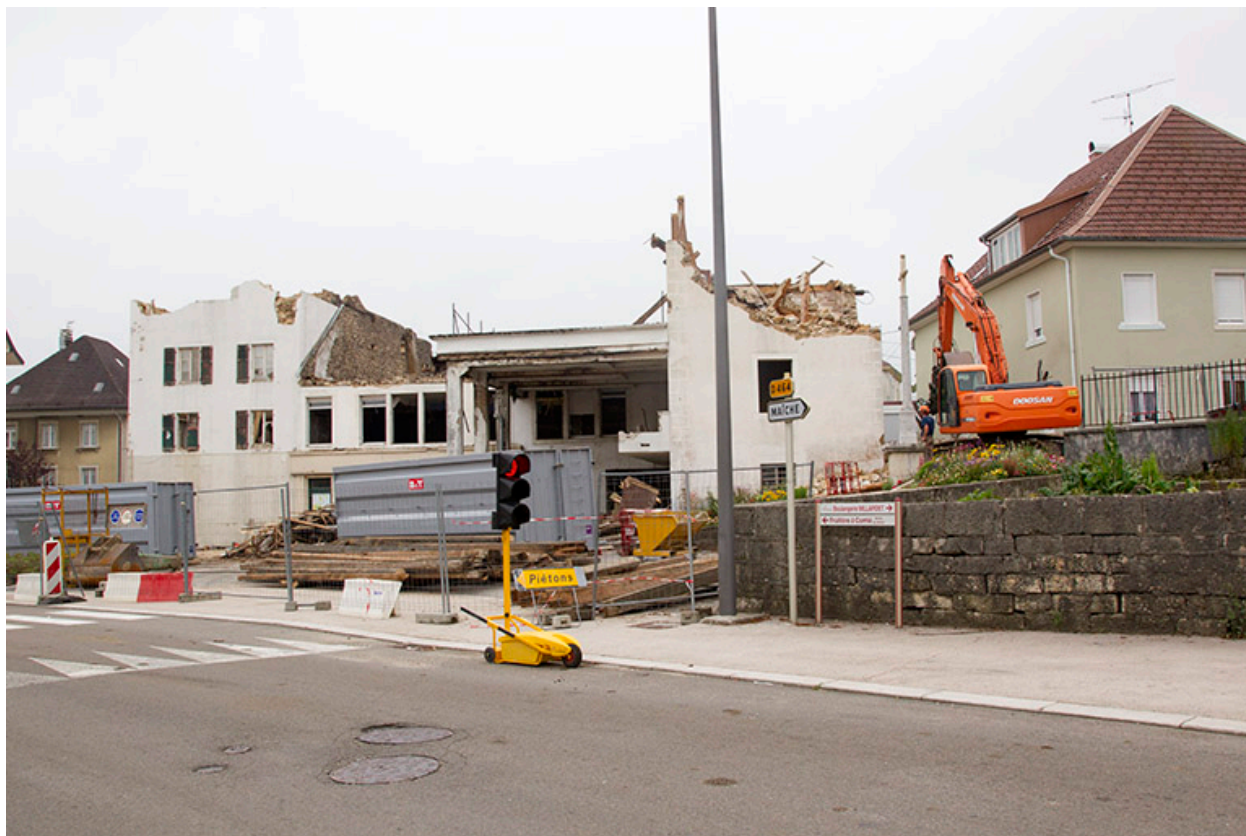
Destruction des bâtiments, 5 septembre 2012 : façades nord.
