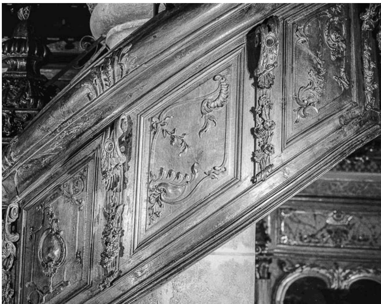
Un panneau de la rampe.
