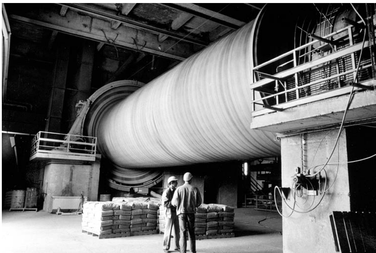
Atelier de fabrication : broyeur de clinkers.
