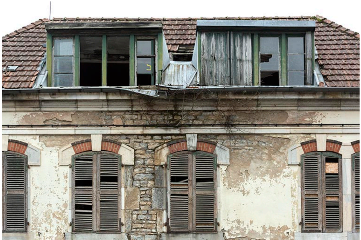
Etat en 2016. Usine A : baies à l'étage carré et à l'étage en surcroît de la conciergerie, côté rue.
