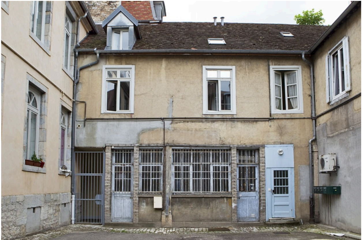
Bâtiment en U : détail de l'aile au fond de la deuxième cour avec un atelier au rez-de-chaussée.
