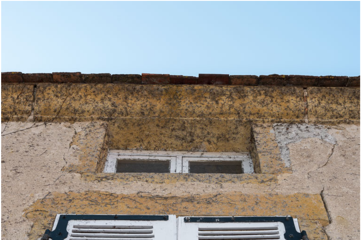
Détail d'une travée et de la corniche de la façade antérieure de la maison
