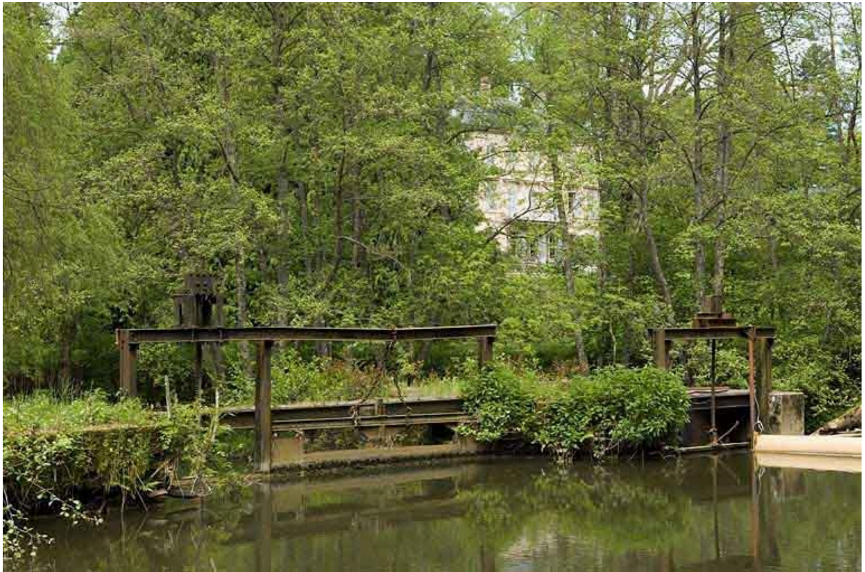
Vannage sur le bief d'amenée.
